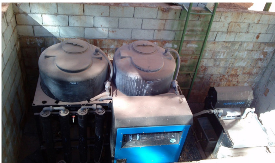
FIGURA 4 - ESTAÇÃO DE TRATAMENTO DE ÁGUA CINZA
