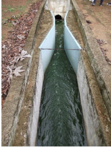
Figura 4 Chegada do esgoto à ETE
